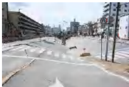
駅舎破壊による道路の陥没
