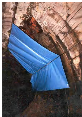
断層によるトンネル断面のズレ
